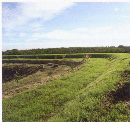
Первый водоем природного типа для накопления воды уже построен, но еще не наполнен водой
